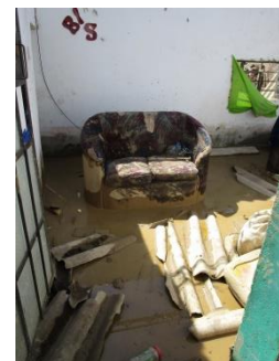
3: Innenraum eines betroffenen Hauses
