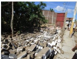
4: Zusammengefallene Hauswand im Viertel Primavera
